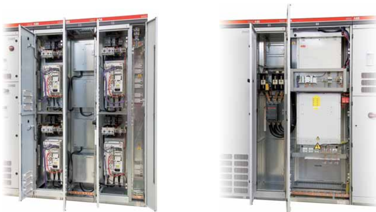
Преобразователи частоты, установленные в распределительном устройстве
